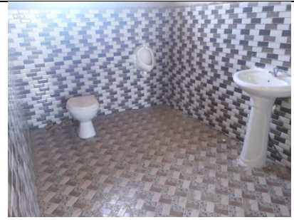
Sanitärraum im Verwaltungsgebäude
