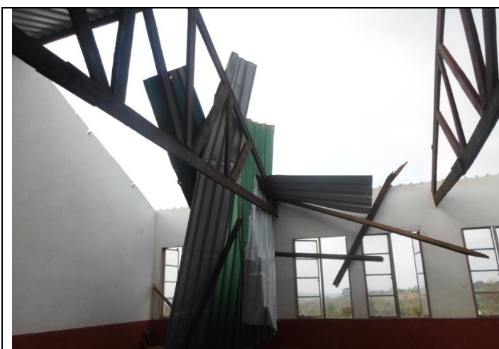
Die Sturmschäden am Dach des Schulgebäudes
